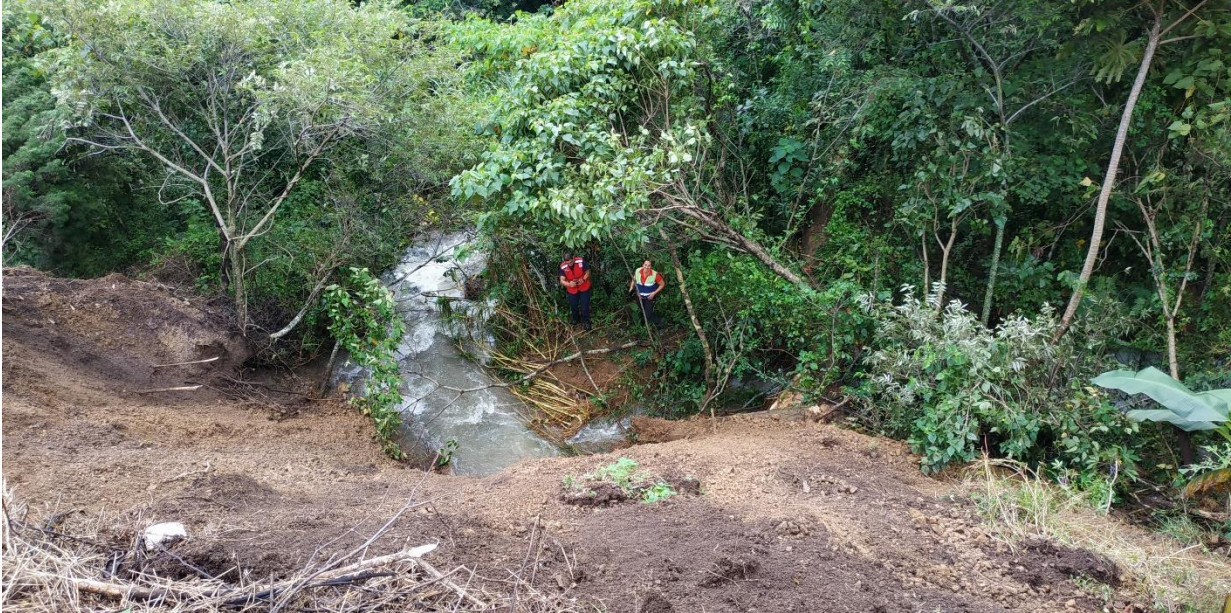
Fotografía N°7. Meandro de la quebrada exactamente en el vórtice del deslizamiento. Fuente propia.
