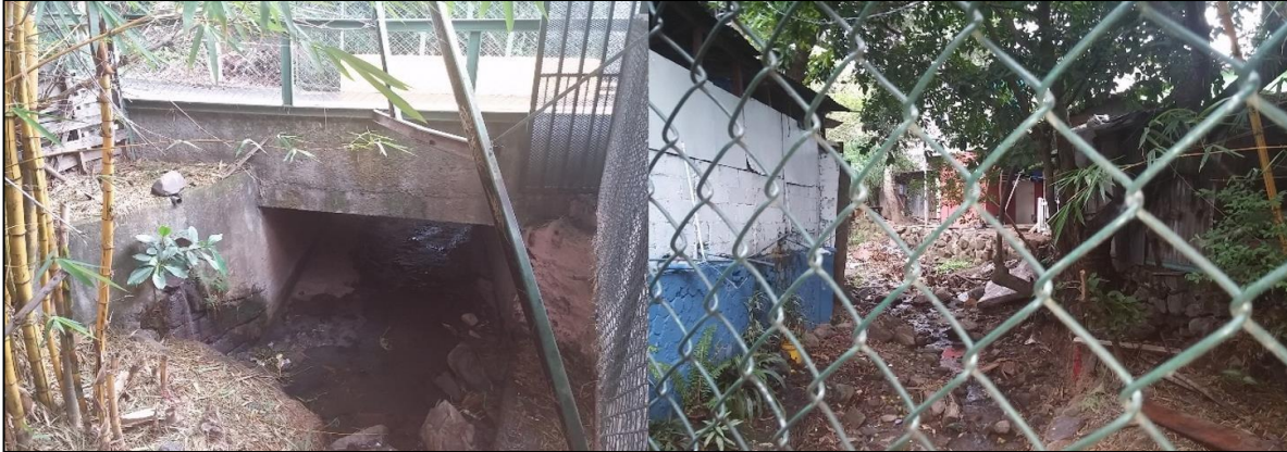
Fotografía N° 14. A) entrada al puente 2 con la obstrucción de los bambúes y la limitada capacidad hidráulica; B) vista margen derecha aguas arriba del puente 2, tomadas de Masis (2015b).
