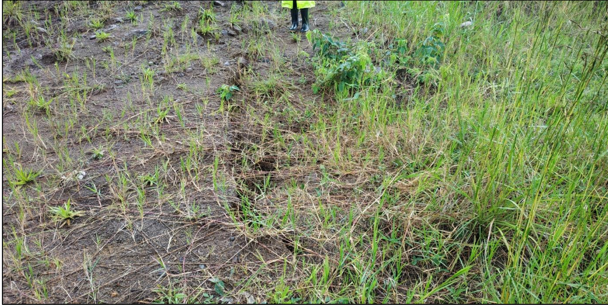
Fotografía N° 23. Misma grieta observada en la fotografía anterior, el 5 de noviembre del presente año 2020. Fuente: Propia.
