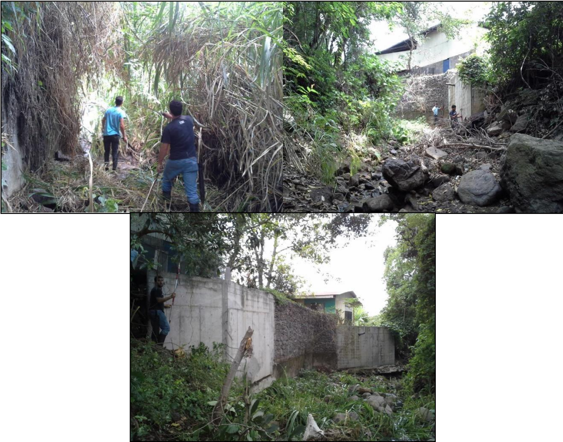
Fotografía N° 19. Condiciones del cauce aguas arriba del puente 2, tomadas de Masis (2015b).
