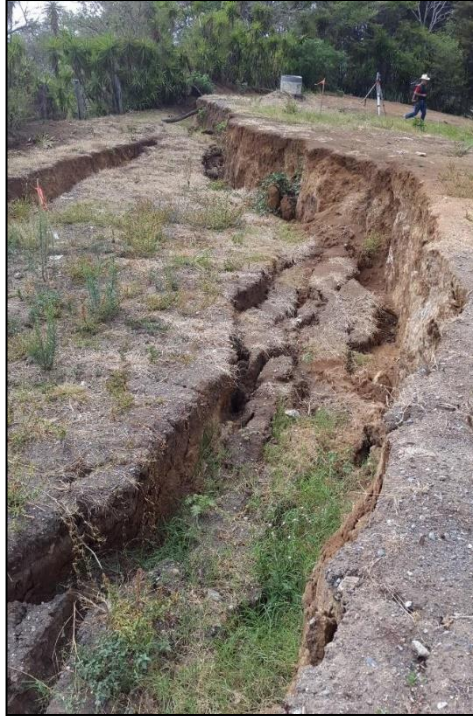
Fotografía N° 8. Vista de las grietas generadas, en dirección casi paralela al cauce, hacia el noroeste, tomado de Masis (2015a).
