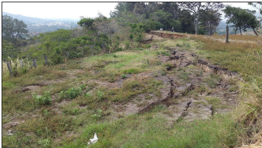
Fotografía N° 7. Zona del deslizamiento, mayo del 2015, tomado de Masís (2015a).
