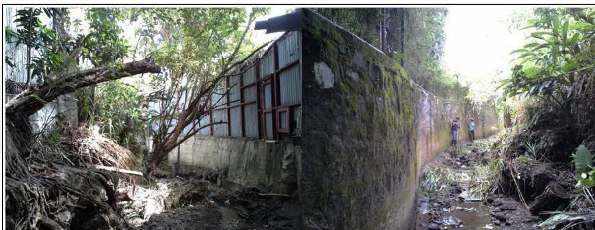
Fotografía N° 16. A) condición de cauce 30 m aguas arriba del puente 2; B) se evidencia la degradación del cauce, tomadas de Masis (2015b).
