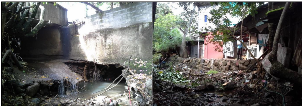
Fotografía N° 15. A) erosión a la salida del puente 2; B) vista de margen izquierda 15 m aguas arriba del puente 2, tomadas de Masis (2015b).
