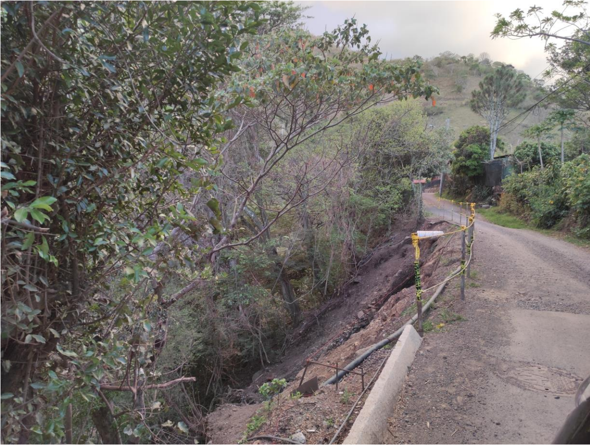
Figura 5. Ubicación del deslizamiento junto a la calle
