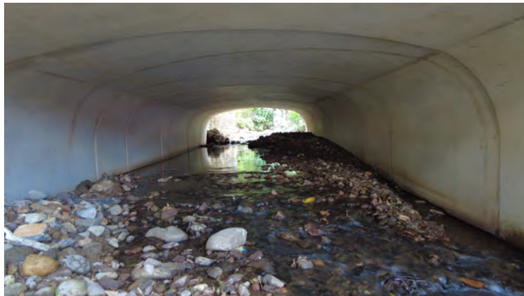
Figura 4.6: Sedimentación a la entrada de la alcantarilla sobre la Ruta Nacional No. 121
