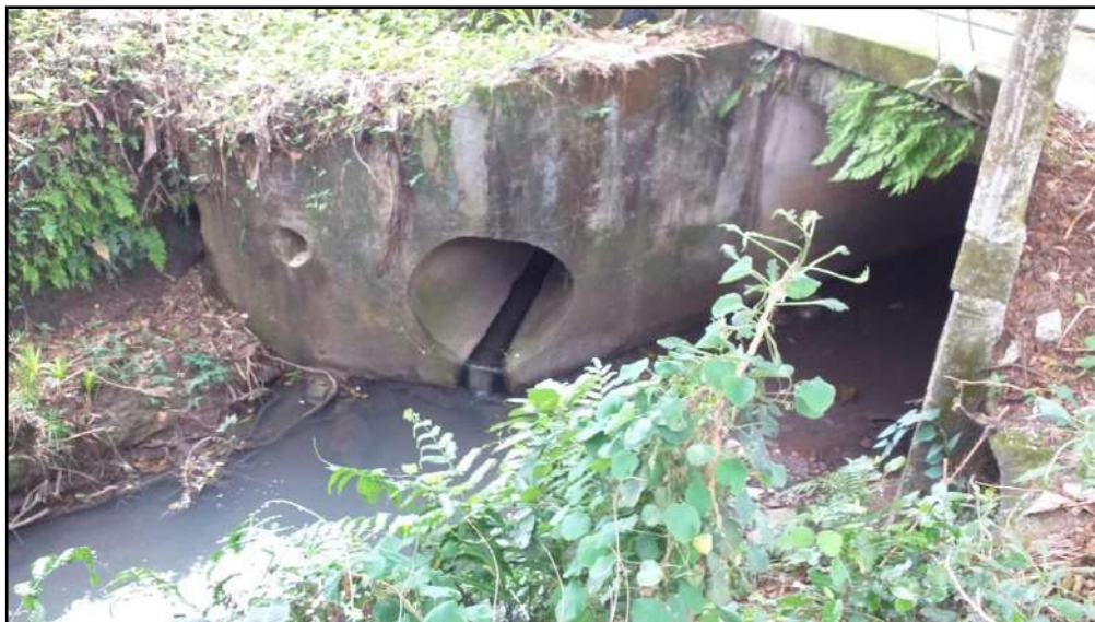
Fotografía N°8. Punto 2: sector bajo de la urbanización Bosques de Santa Ana sitio analizado por Hcanales. Coordenadas: 479102E /1101813N proyección CRTM-05.
