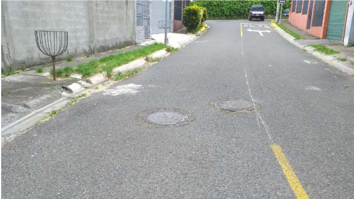
Fotografía N°26. Sector con problemáticas de inundación, entre los bloques A, E y B: 479169E /1102035N proyección CRTM-05.
