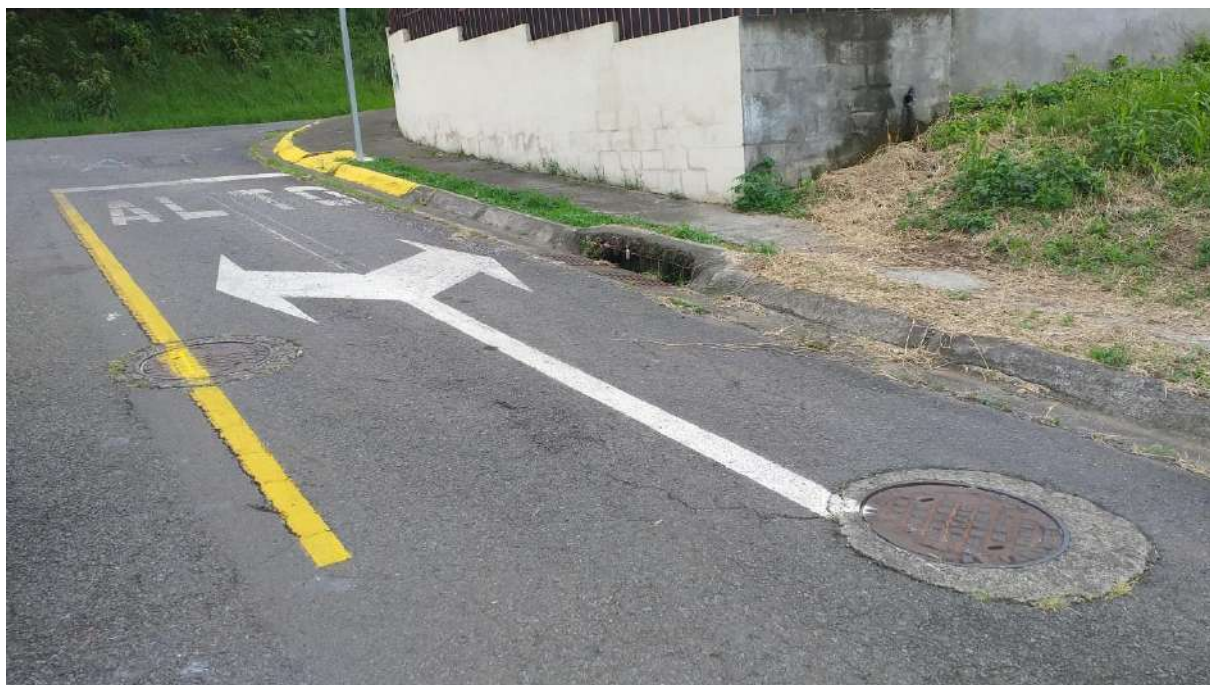
Fotografía N°32. Sector con problemáticas de inundación, en Calle 22A: 478988 E /1101983 N proyección CRTM-05.
