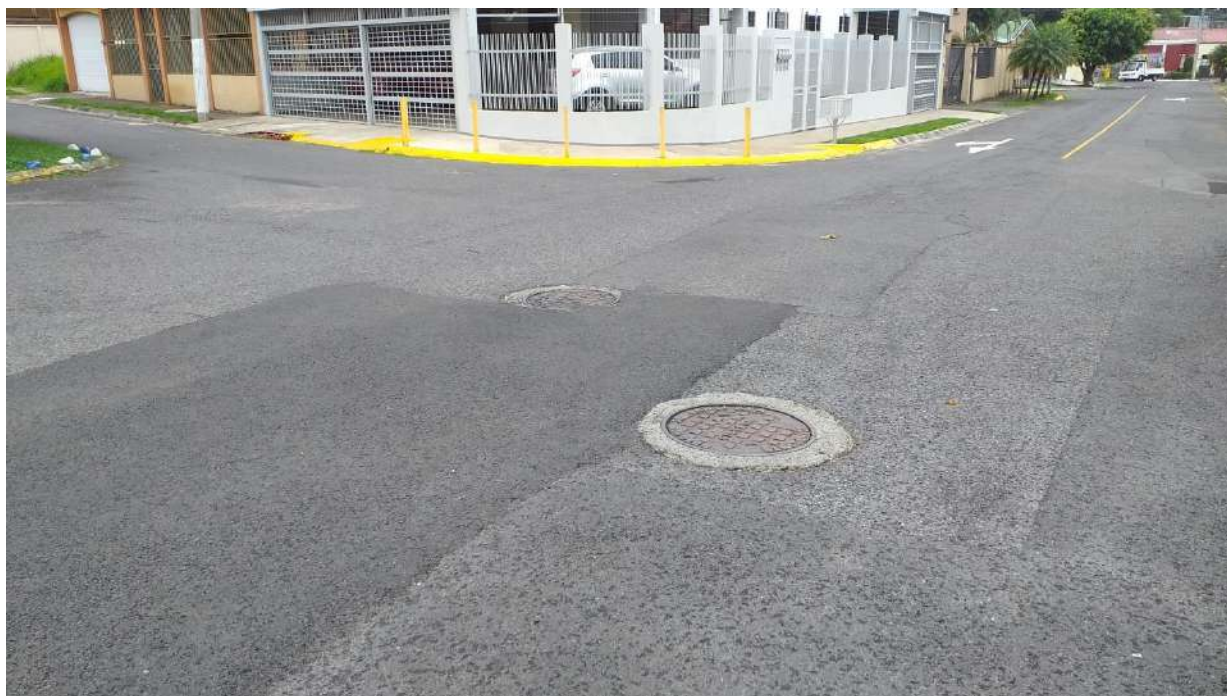
Fotografía N°29. Sector con problemáticas de inundación, entre los bloques E, G y Q: 479212 E / 1102041 N proyección CRTM-05.
