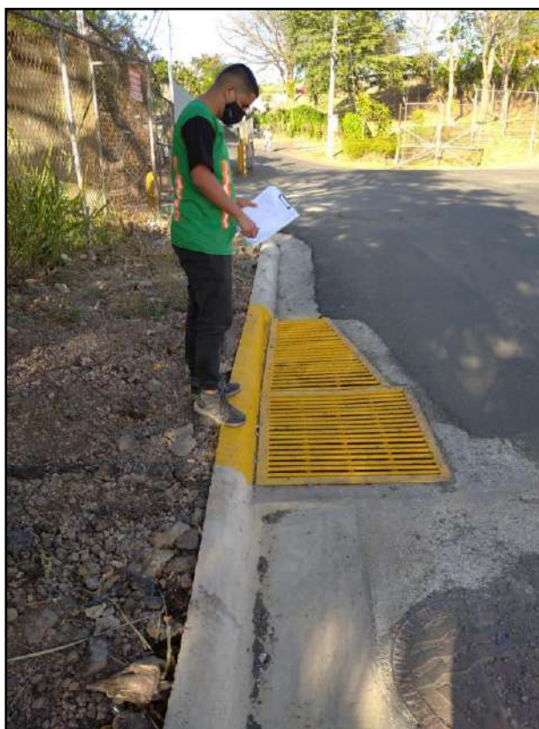
Fotografía N°25. Construcción de tragante pluvial por el AyA, en la entrada del tajo MECOSANTANA: 479324E / 1102236N proyección CRTM-05.
