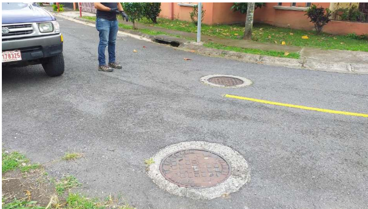
Fotografía N°33. Sector con problemáticas de inundación, entre los bloques O y P: 479029 E / 1101828 N proyección CRTM-05.
