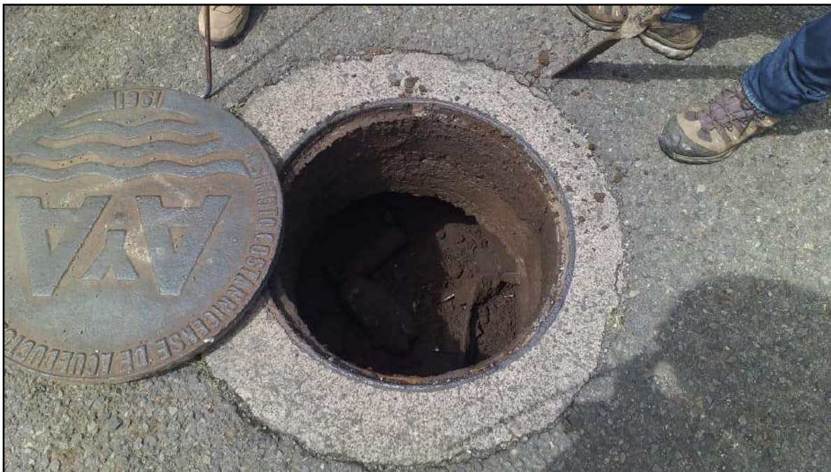
Fotografía N°20. Alcantarilla sedimentada sin capacidad de evacuación pluvia. Coordenadas: 479205 E / 1101903 N proyección CRTM-05.
