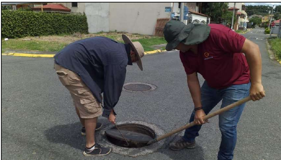
Fotografía N°16. Levantamiento de las condiciones actuales de la red pluvial sobre la urbanización Bosques de Santa Ana. Coordenadas: 479289E /1101894N proyección CRTM-05.
