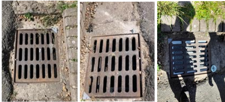
Ilustración 25: Tragante con filtro de sistema de captación
