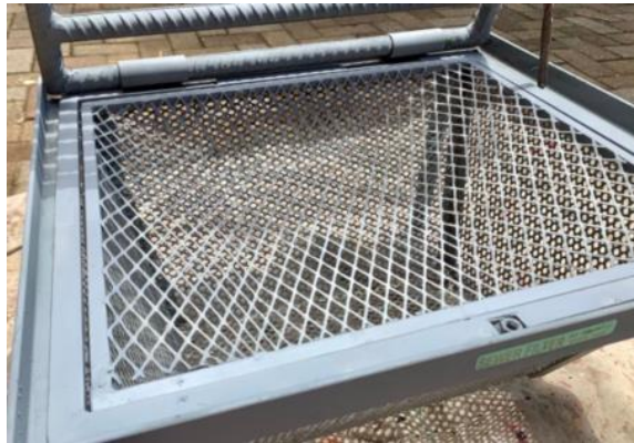
Ilustración 22: Filtros de captación
