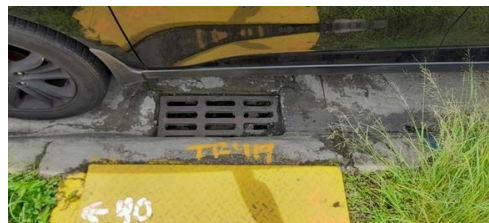
Ilustración 40: Tragantes sin acceso
