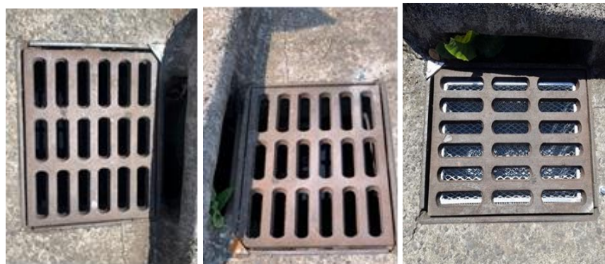
Ilustración 29: Tragante con filtro de sistema de captación
