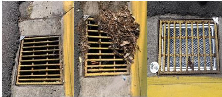
Ilustración 26: Tragante con filtro de sistema de captación
