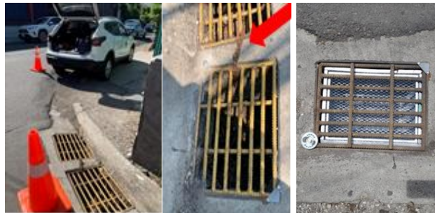
Ilustración 32: Tragante con filtro de sistema de captación
