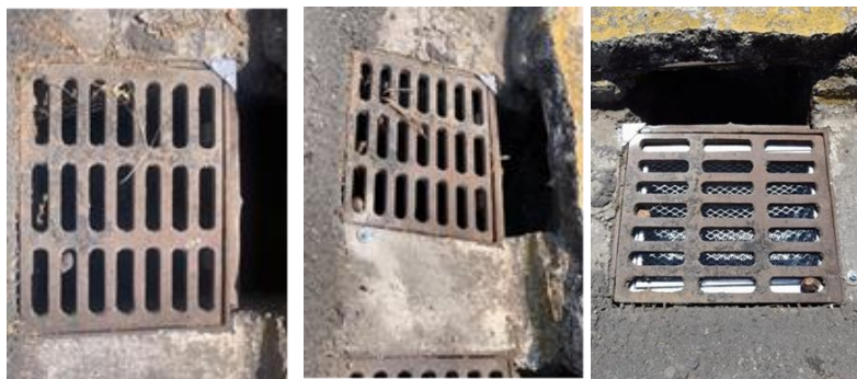
Ilustración 30: Tragante con filtro de sistema de captación
