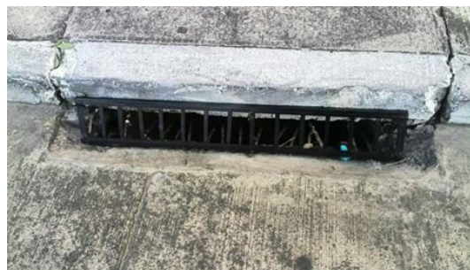
Ilustración 44: Tragantes sin acceso - 5
