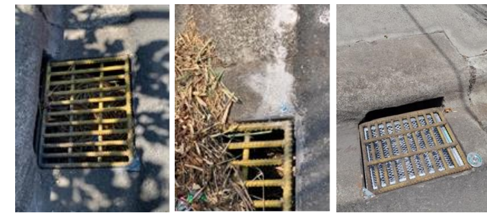
Ilustración 27: Tragante con filtro de sistema de captación
