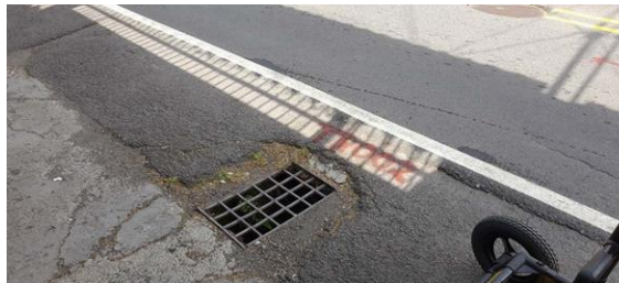
Ilustración 43: Tragantes sin acceso - 4
