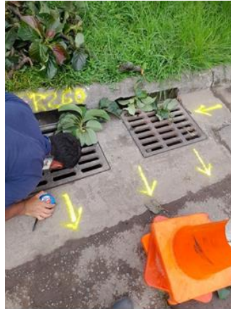
Ilustración 42: Tragantes sin acceso - 3
