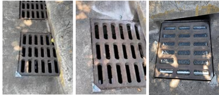
Ilustración 28: Tragante con filtro de sistema de captación
