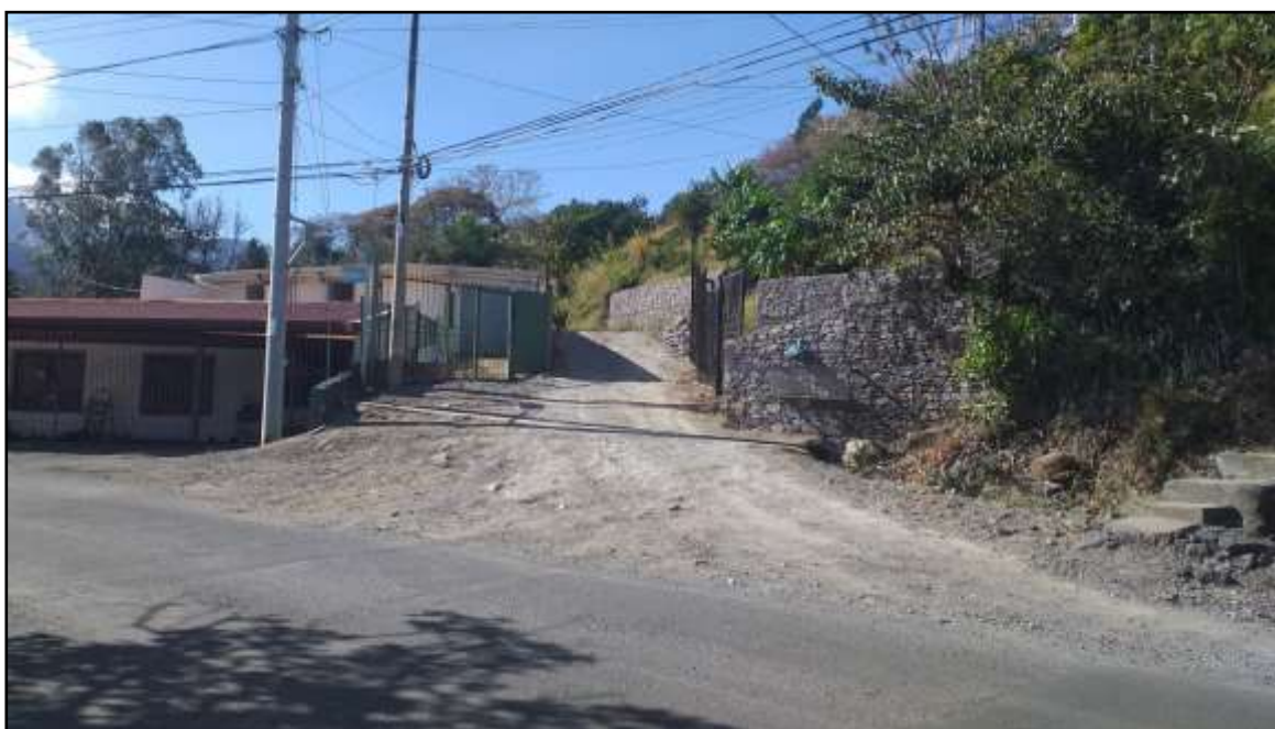
Fotografía N°11. Entrada frente a Clínica Drs Méndez, sitio que impulsa escorrentía y arrastre de materiales, además se han dado deslizamientos según criterio de vecinos: 479865E / 1097042N proyección CRTM-05.
