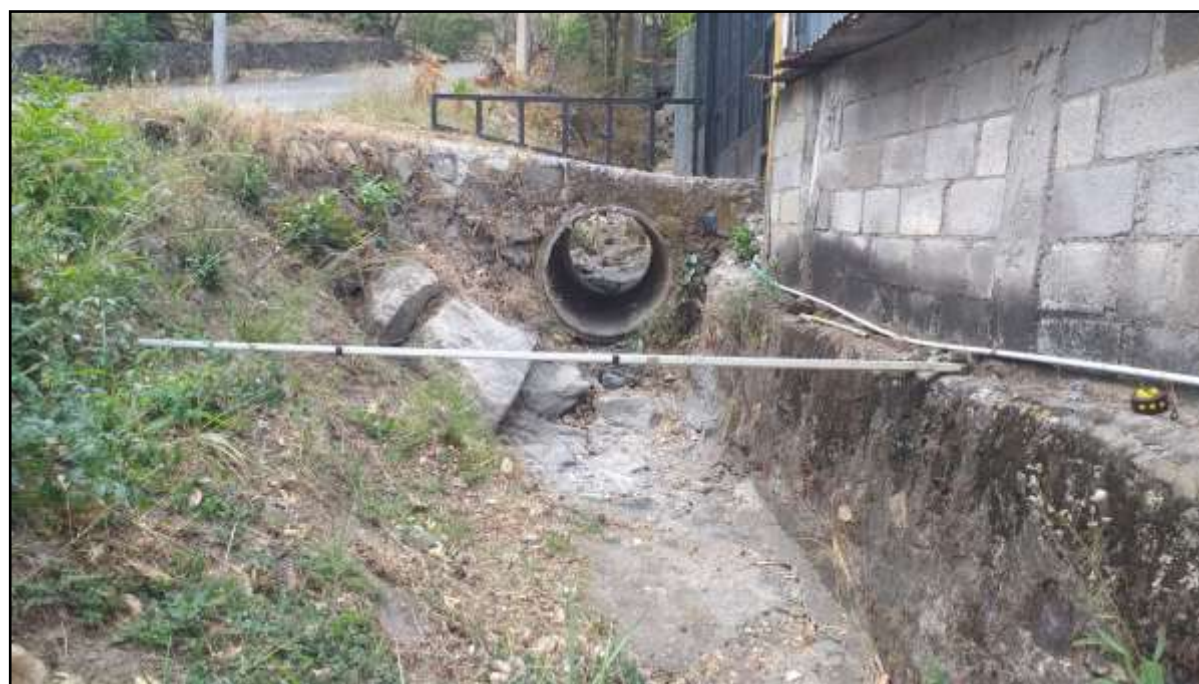
Fotografía N°7. Sector H3, canal parabólico colindante a vivienda donde traza la tubería pluvial. Coordenadas: 479687E /1097275N proyección CRTM-05.
