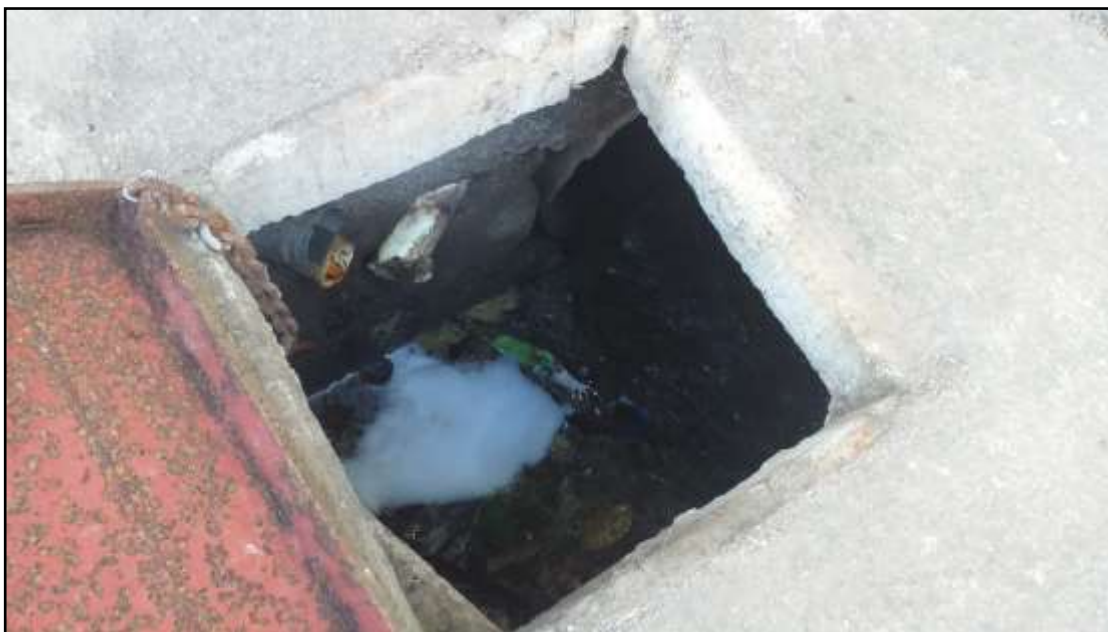
Fotografía N°9. Aporte de Aguas residuales al sistema pluvial. Coordenadas: 479785E / 1097215N proyección CRTM-05.
