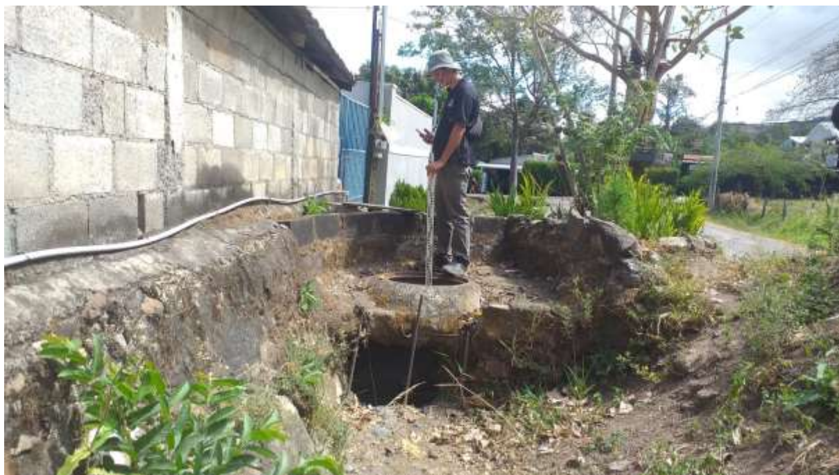
Fotografía N°18. Sector con problemáticas de inundación por colapso del sistema por el sobre flujo de escorrentía: 479687E /1097275N proyección CRTM-05.
