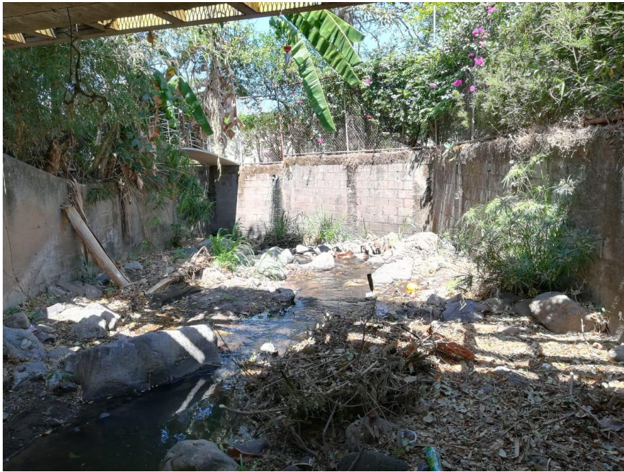
Figura 2.18 (cont.). Condición del cauce del río Corrogres en el sitio del puente 6
